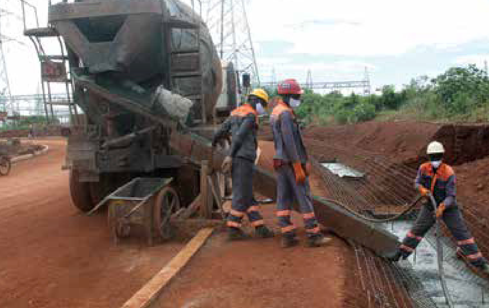
FOTO DE XINHUA / ZHANG VENDU IMAGENS DE GETTY. Construção no projeto hidrelétrico Karuma em Uganda
